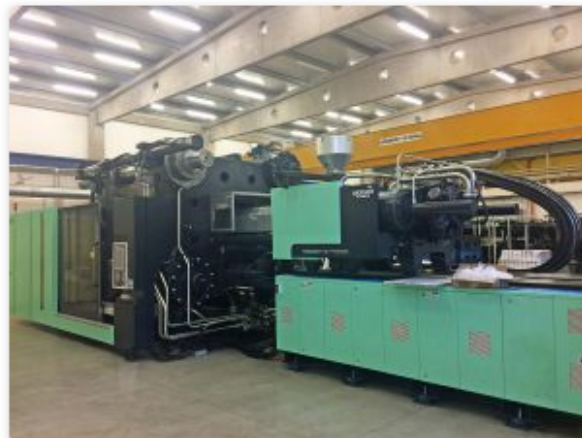
Inbetriebnahme der DL-A5 1800 bei RenoStav in Zábřeh na Moravě. (Foto: Woojin Plaimm)
